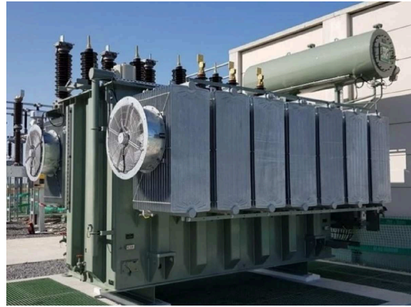
Radiateurs sur un transformateur
